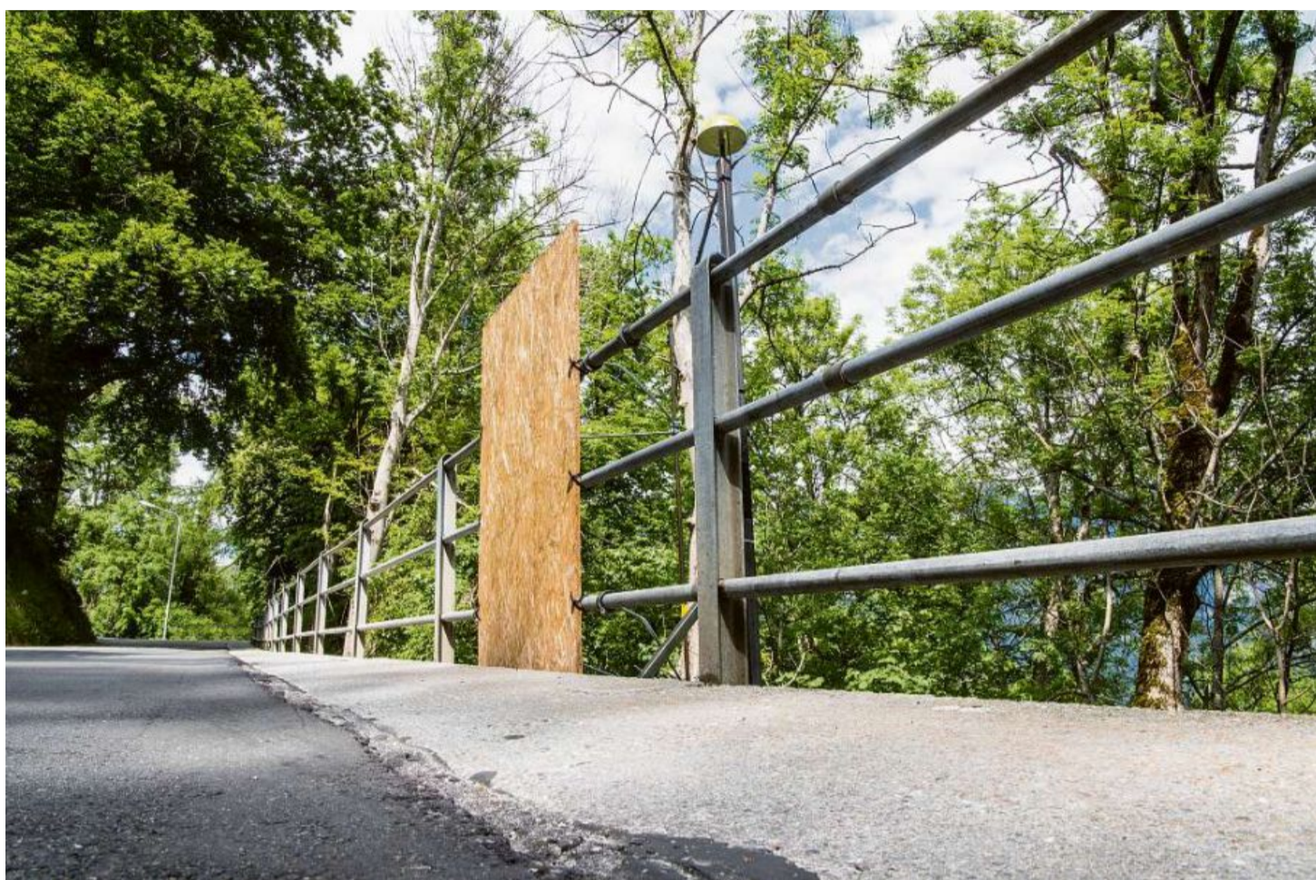
Unter permanenter Überwachung: Schäden an Belag und Stützmauer deuten darauf hin, dass sich die Heinzenbergstrasse in Thusis bei der Abzweigung in den Dalauerweg talwärts bewegt. Das Gebiet wird nun mit einem GPS-System überwacht. Bild: Philipp Baer
